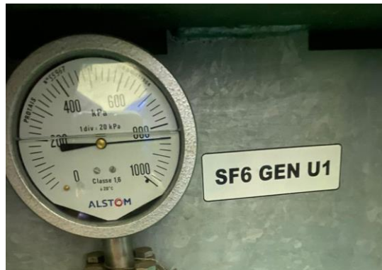
Gambar 4.6 Tekanan standar gas SF6 setelah di isi kembali
